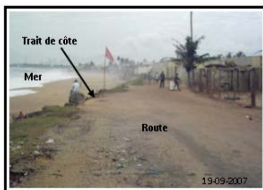
Figure 6. Route interrompue par l'érosion au Phare de Port-Bouët.
