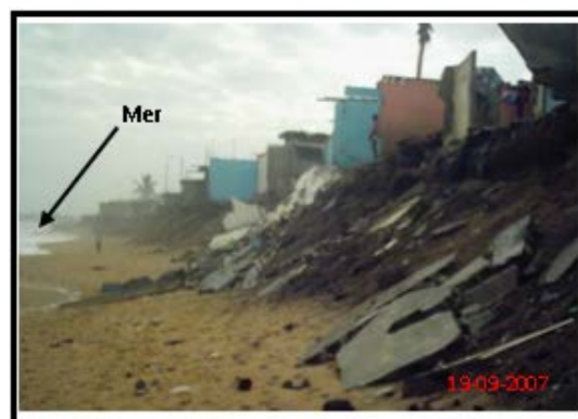
Figure 7. Dégâts causés par la tempête d'août 2007 à l'ouest du Phare.
