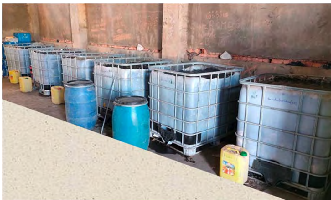
Figure 4. Disposition des cuves C1 à C6 sous hangar.
