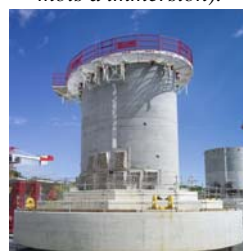
Figure 8. Vingt modules Panals sont scellés sur chacune des six piles de viaduc.
